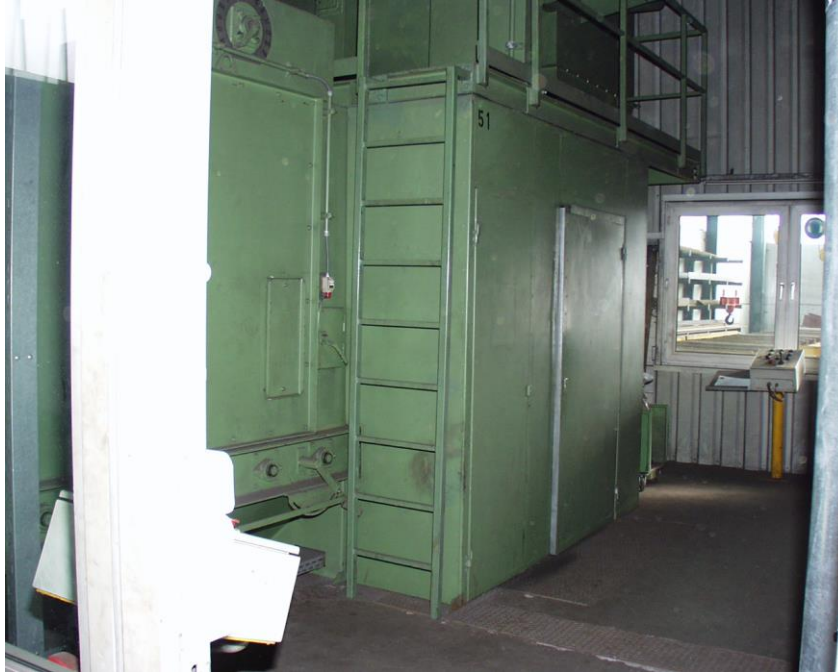
Anh.1, Abb. 42: Blick in die geöffnete begehbare Kabine
