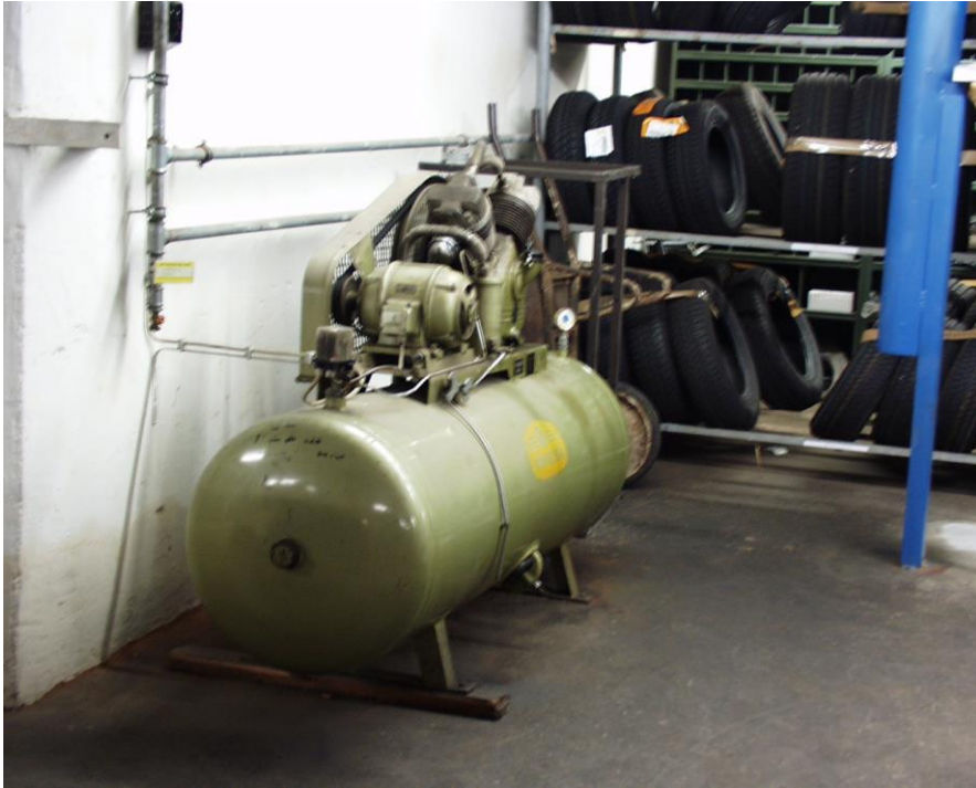
Anh.1, Abb. 20: Kompressorraum in der Kfz-Werkstatt
