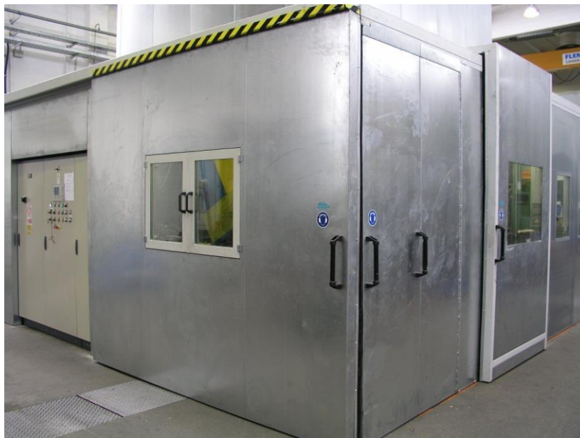
Abb. 7.1: Begehbare Maschinenkapsel für eine Stanzmaschine
