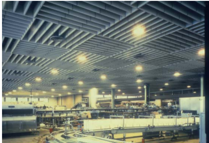
Bild 1 Schallabsorbierende Kulissendecke in einem Getränkeabfüllbetrieb
